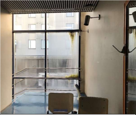
Seurakuntakeskuksen rakenteet eivät ole kestäneet suomalaisen sään aiheuttamia rasituksia ilman vaurioita. (Lappeenrannan kaupunkisuunnittelu)
